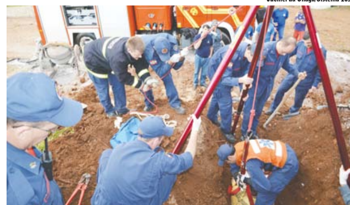
Vítima que foi soterrado trabalhava na obra da fossa de sua residência
