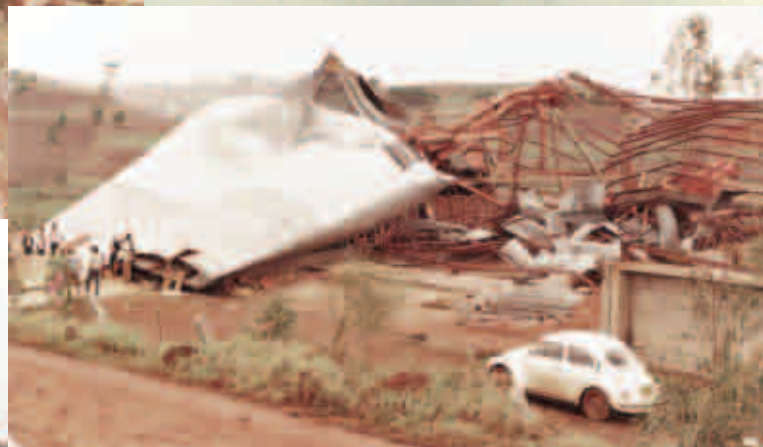
Silo da cooperativa foi derrubado
