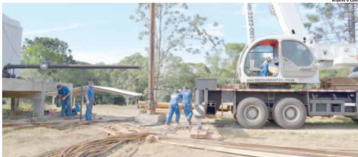
Um dos projetos é um recalque com adutora para captação da água do poço profundo que será direcionada aos reservatórios de distribuição localizados no centro da cidade
