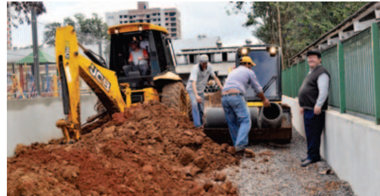
Tubulação é instalada, agora a comunidade busca recursos para dar continuidade a construção
