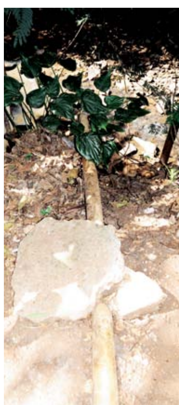
Esgotos são largados diretamente no rio
