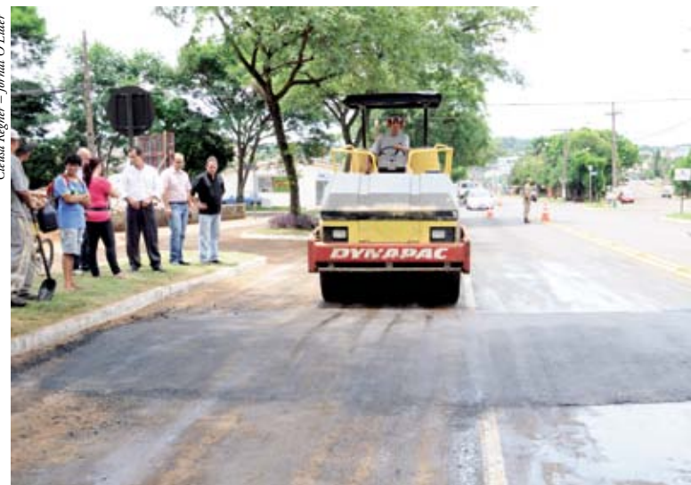
Prefeito em exercício, Aldcir Seiffert, e equipe da Prefeitura acompanharam a obra
