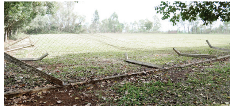
Aproximadamente 80% do cercado foi destruído
