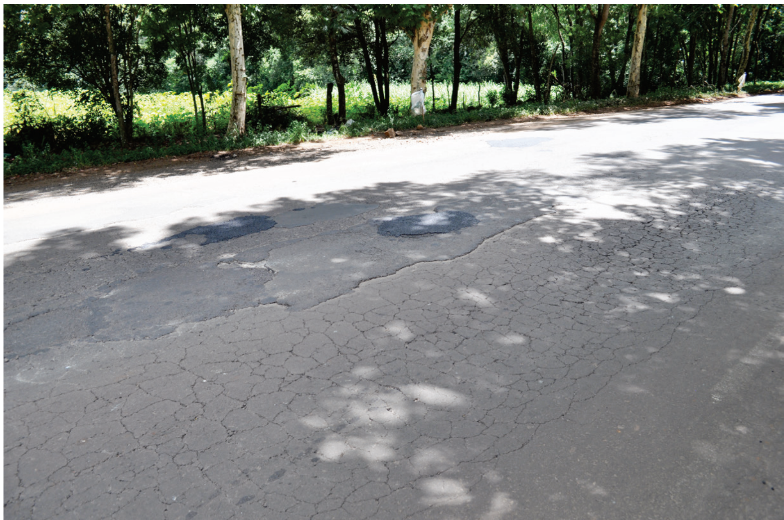
Irregularidades do trecho da SC-469
