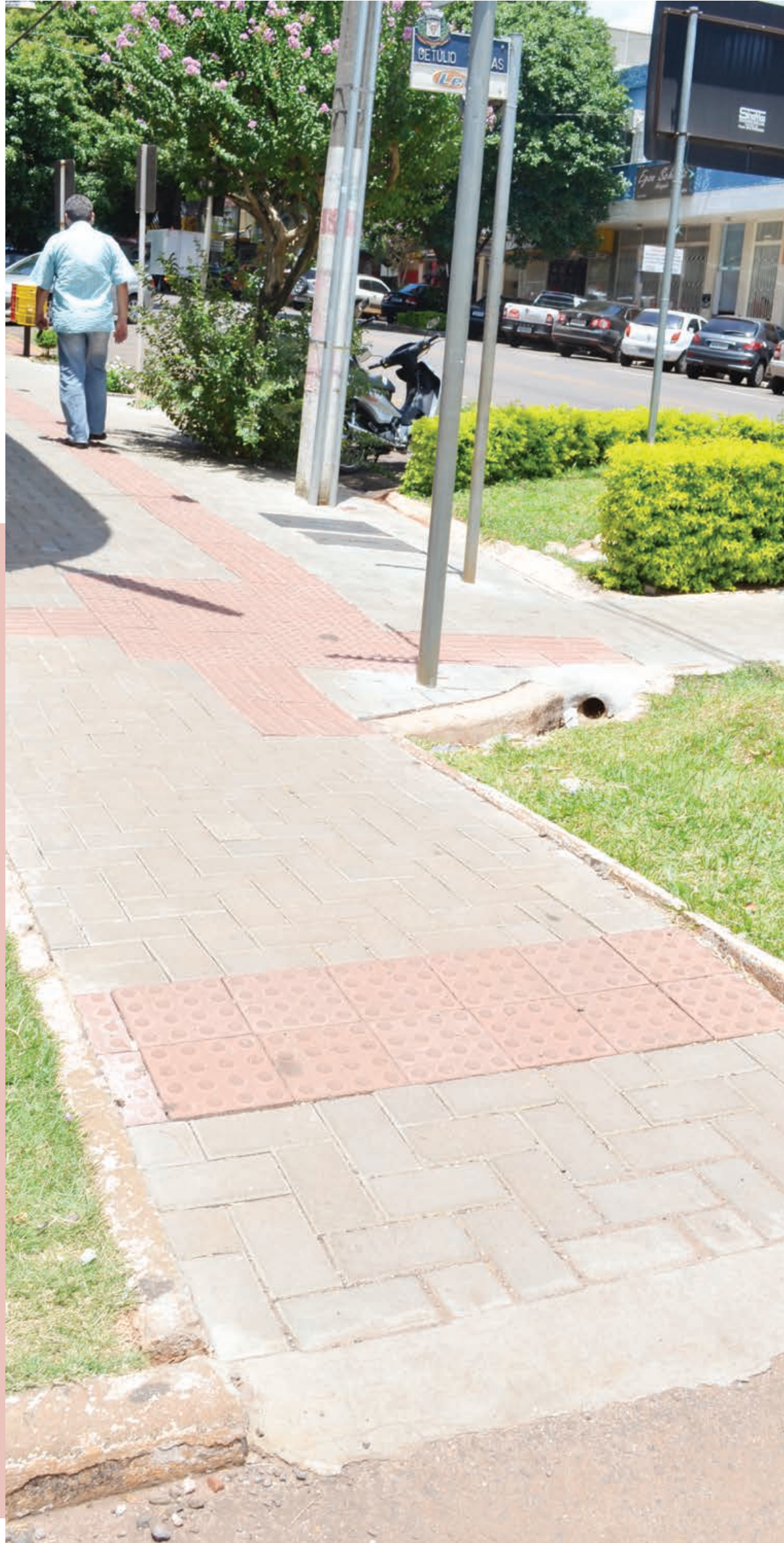
Em São Miguel do Oeste, construção de novas calçadas também segue os padrões de acessibilidade
