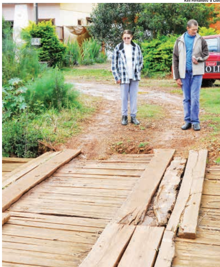
Moradores reclamam a situação da estrada e da ponte no Bairro São Luiz
