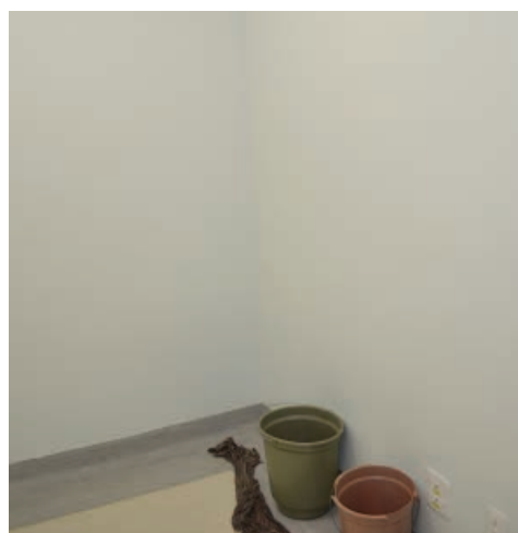
Problemas na infraestrutura foram verificados
